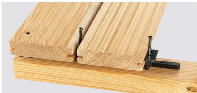
Die nächsten Dielen ansetzen, ausrichten, fixieren und mit der vorherigen Diele verschrauben. Achten Sie auf die richtige Drehmomenteinstellung Ihres Montagewerkzeuges. Schrauben nicht überdrehen. Ein Nachjustieren ist jederzeit möglich.
